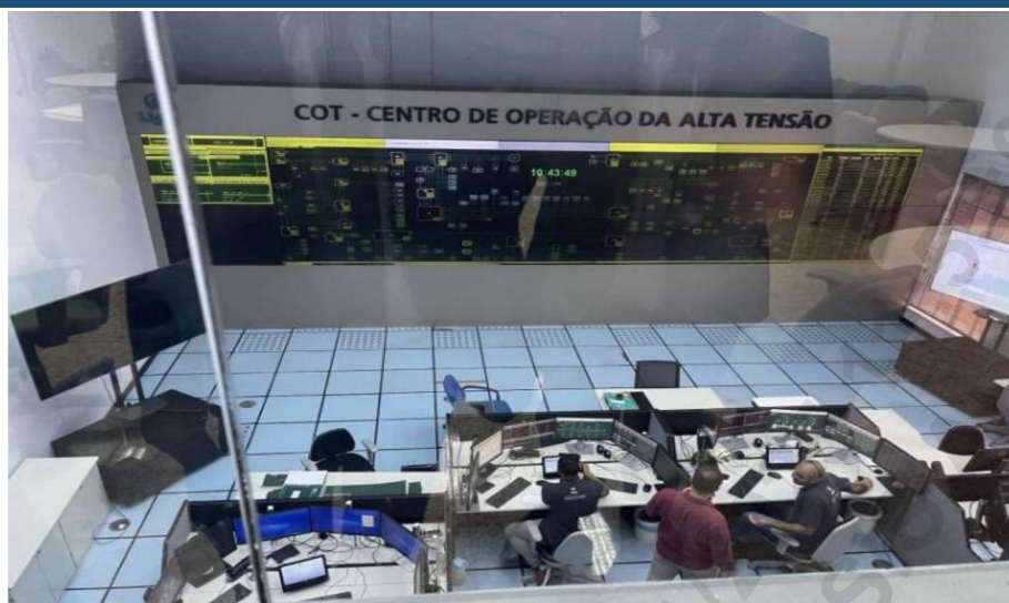
Figura 4 - Centro de Operação de Alta Tensão – COT
