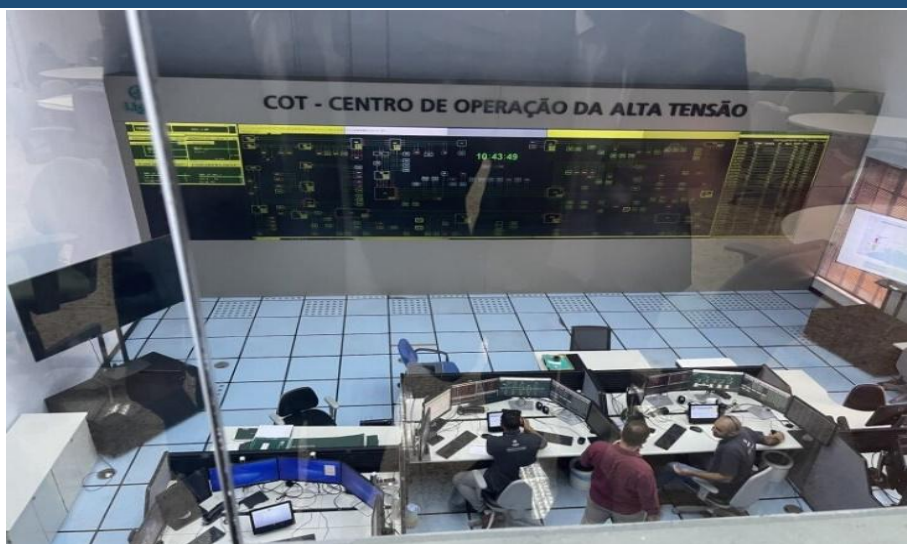
Figura 4 - Centro de Operação de Alta Tensão – COT
