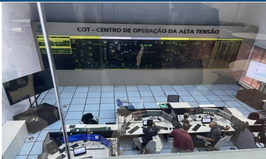
Figura 4 - Centro de Operação de Alta Tensão – COT
