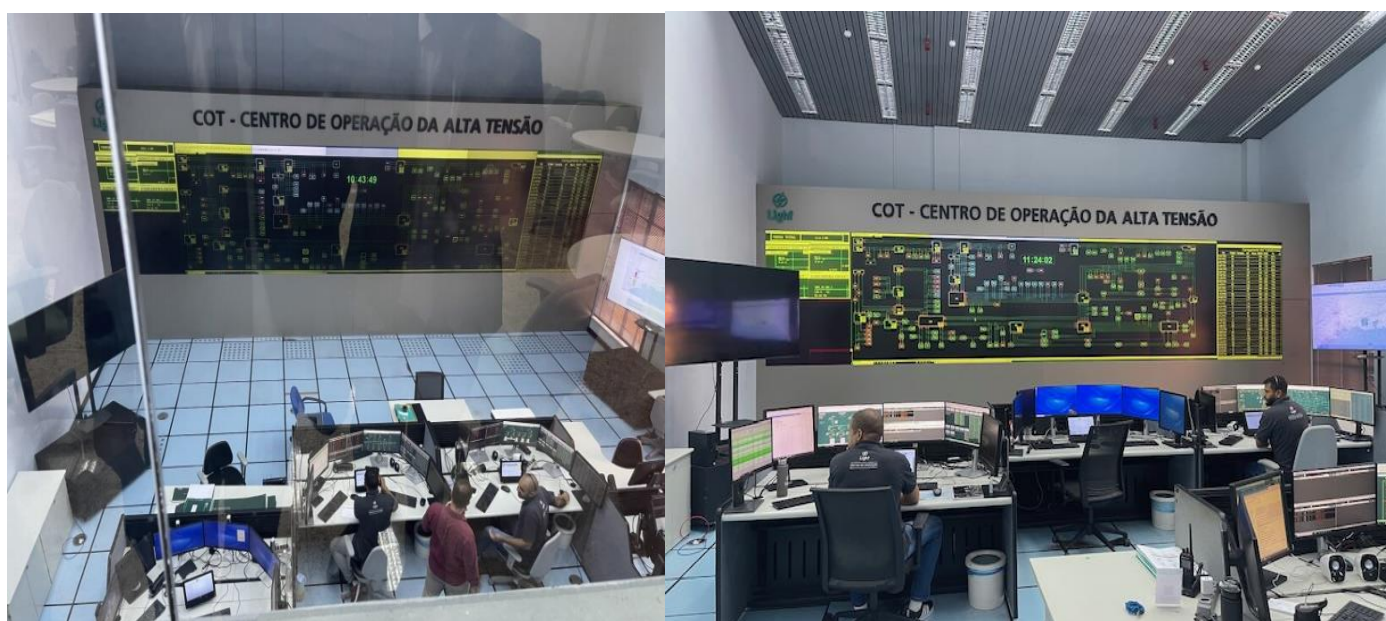
Figura 5 - Centro de Operação da Alta Tensão – COT
