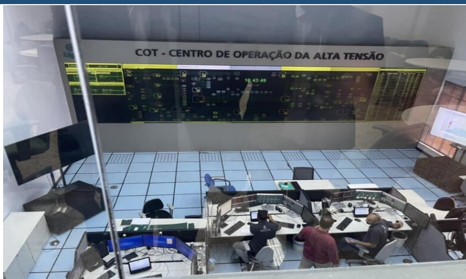
Figura 4 - Centro de Operação de Alta Tensão – COT
