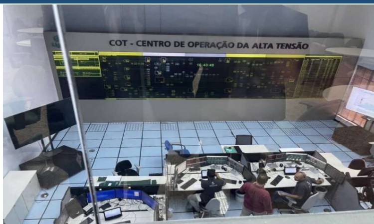
Centro de Operação de Alta Tensão – COT
